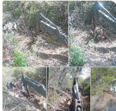
Excavación realizadas en área intervenida. Se observa la realización una cala, mediante el empleo de mano de obra así como de maquinaria pesada
