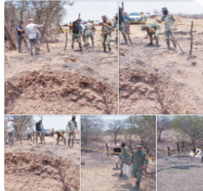
Cerco de seguridad establecido para que no halla paso de algun animal hacia el interior del pozo. Y cierre de jornada laboral.
