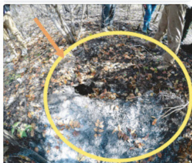
1er punto: Hundimiento del terreno.
